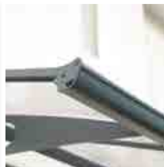
Beépített vízlevezető csatorna
